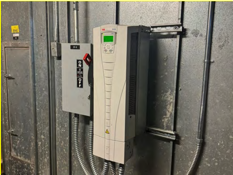
AHU fan VFD
