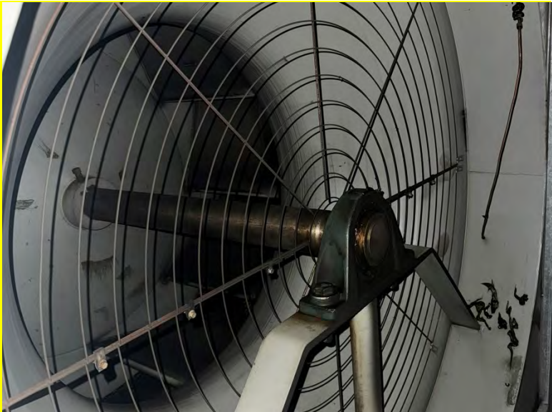
Bowl AHU supply fan
