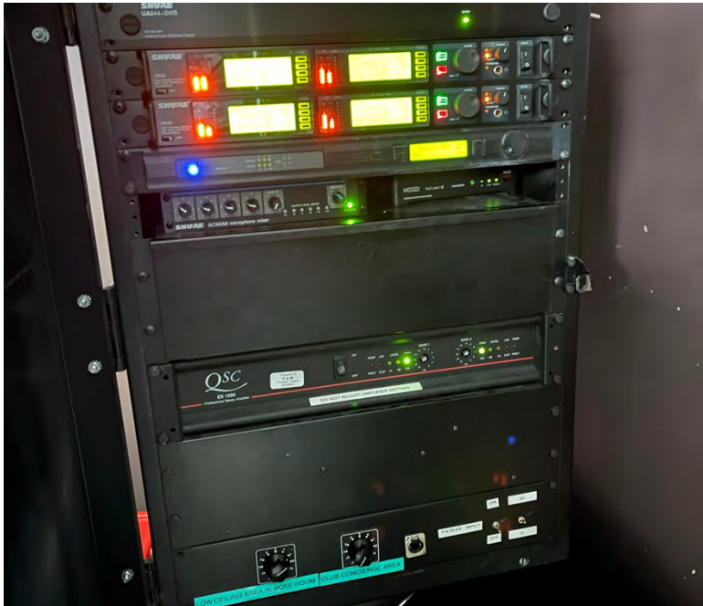
Existing club AV control rack
