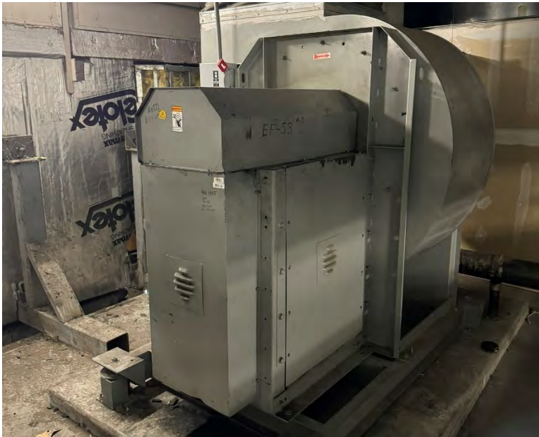
General exhaust fan
