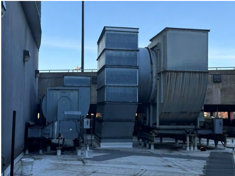
Garden garage ventilation fan
