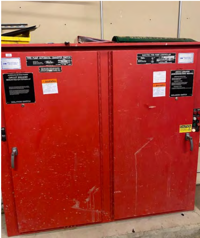
AATS-4 for fire pump
