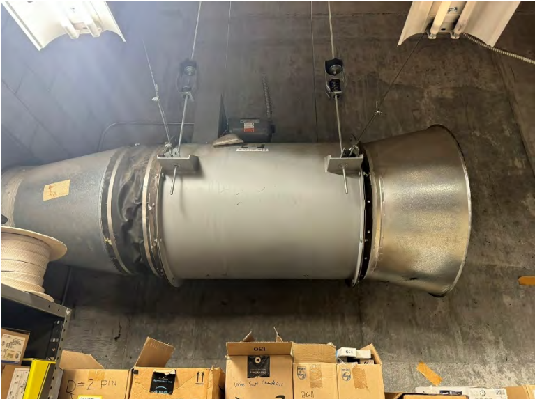
General exhaust fan
