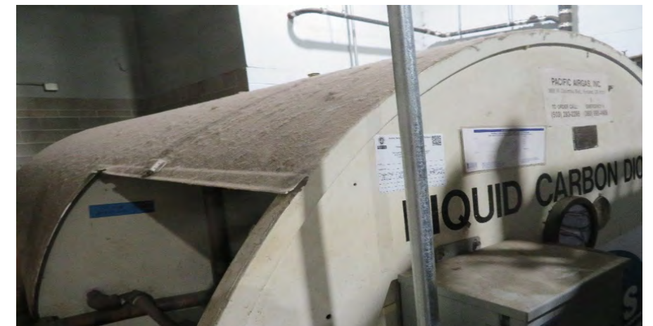
Unused central CO2 carbonator
